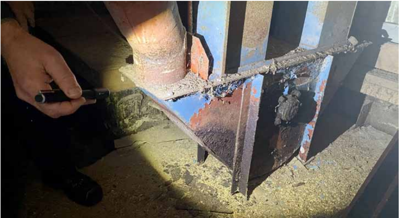
Rostskador på elevatortrumma
