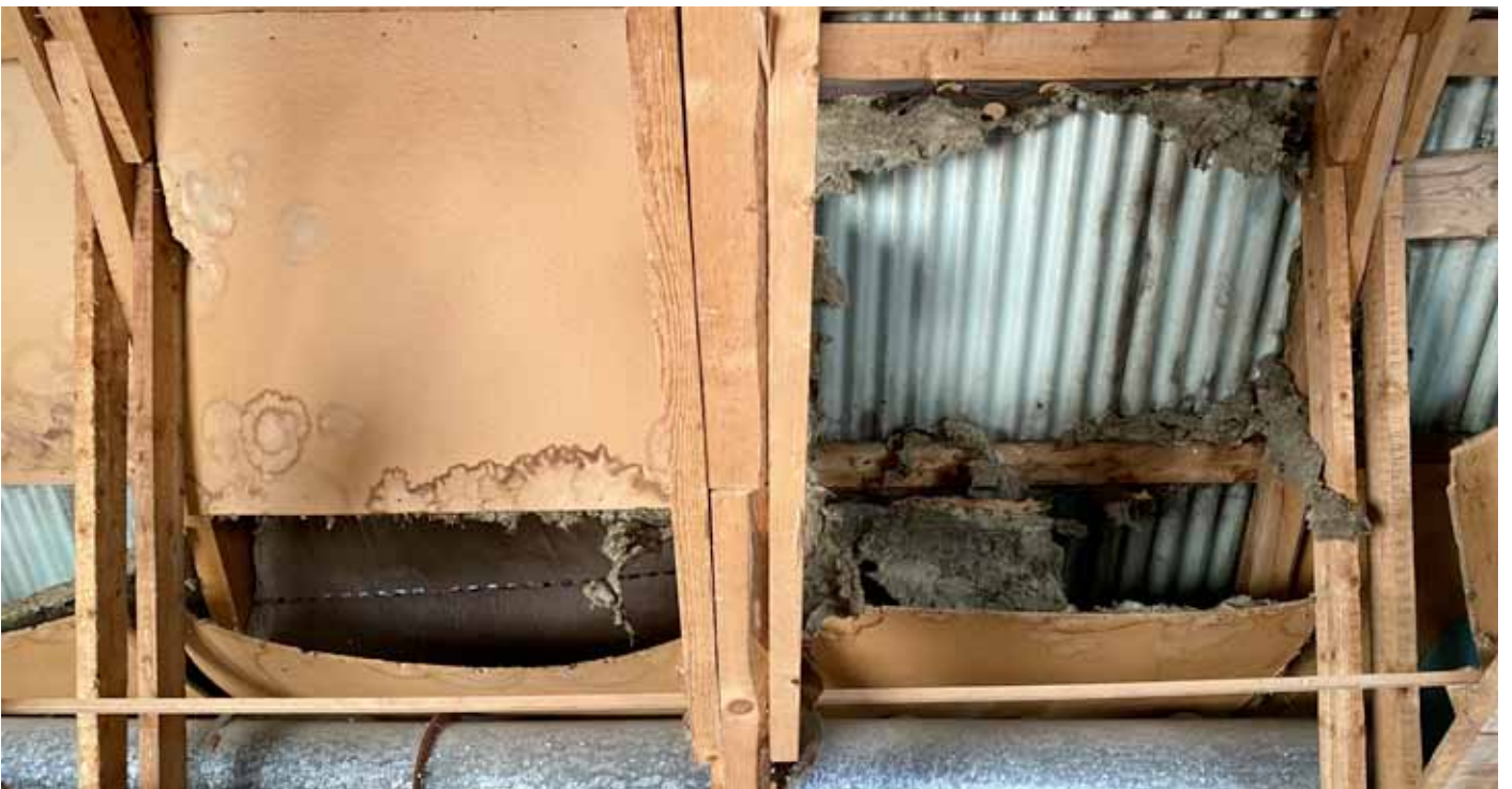
Skador på innertaket
